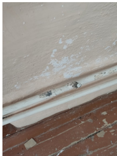
Фото 7.9.1.2 Разрушение лакокрасочного слоя
