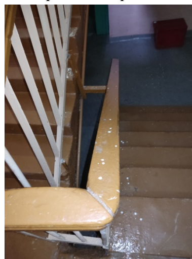
Фото 7.4.8 Деформация каркаса лестничного ограждения, следы многократного окрашивания
