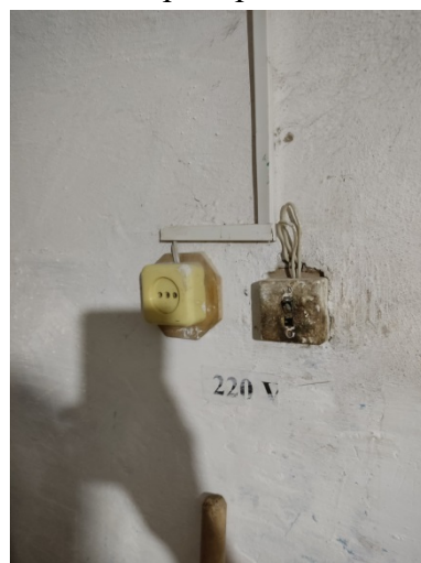
Фото 7.9.4.28 Износ электротехнических приборов
