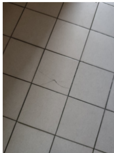
7.3.32 Растрескивание напольной плитки
