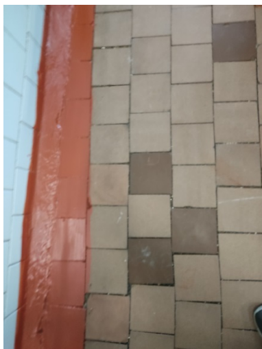
7.3.37 Истирание/износ напольной плитки
