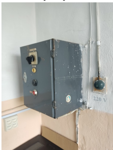
Фото 7.9.4.3 Износ электротехнических приборов
