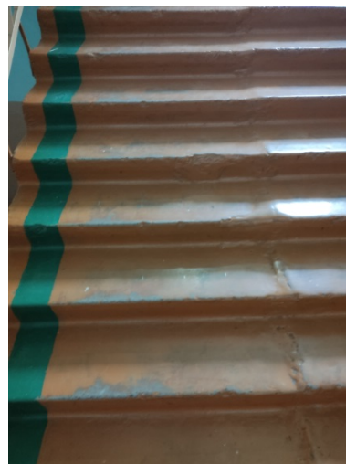
Фото 7.4.10 Истирание лакокрасочного покрытия
