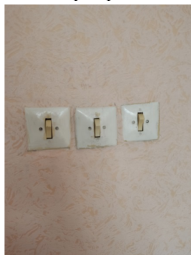
Фото 7.9.4.6 Износ электротехнических приборов
