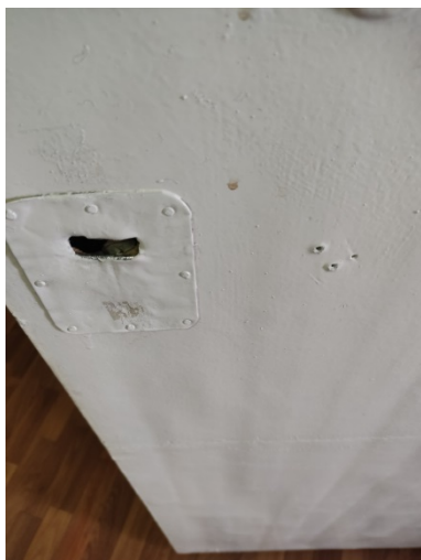
Фото 7.8.13 Наличие ремонтных участков/многократное окрашивание
