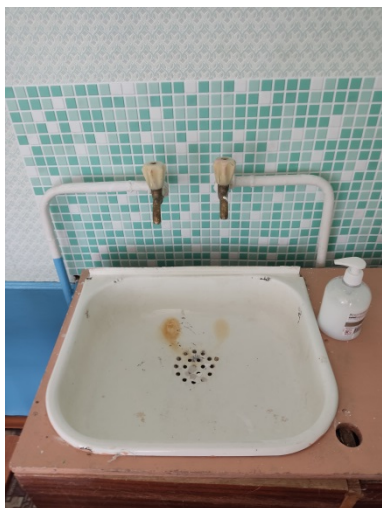
7.9.2.7 Износ санитарно-технических приборов
