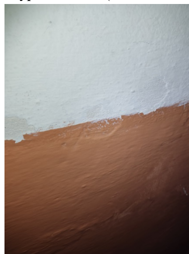
Фото 7.2.32 Нарушение геометрии штукатурного слоя (волны, наплывы)
