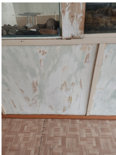
Фото 7.2.25 Разрушение элементов отделки
