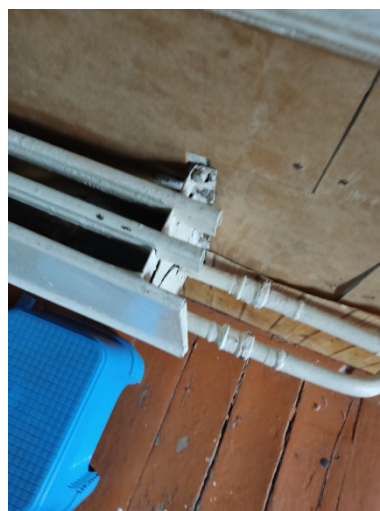
Фото 7.9.1.10 Многократное окрашивание/износ трубопровода
