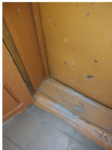
Фото 7.8.20 Рассыхание дверного полотна/износ фурнитуры
