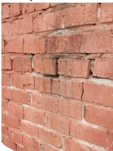
Фото 7.2.11 Следы размораживания кирпичной кладки
