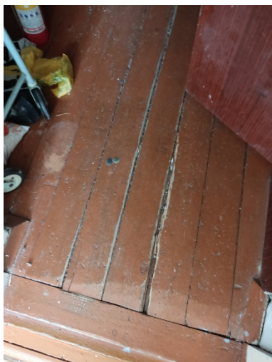
Фото 7.3.13 Рассыхание деревянных элементов пола
