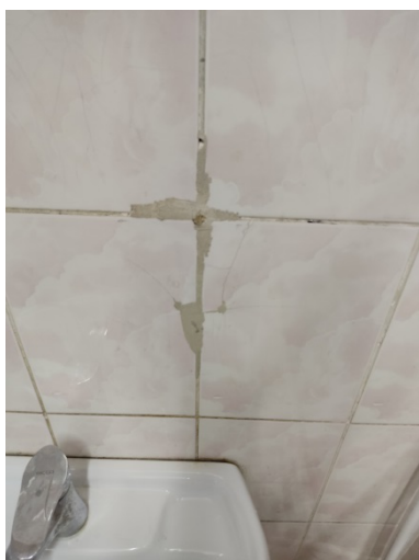
Фото 7.2.29 Разрушение керамической плитки
