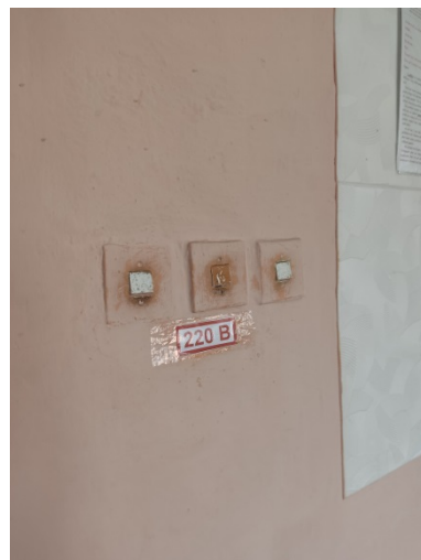
Фото 7.9.4.14 Износ электротехнических приборов
