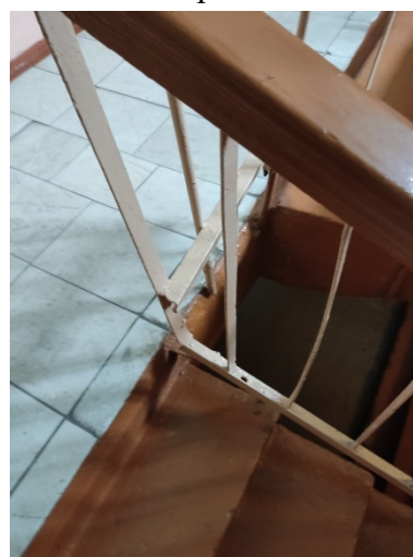
Фото 7.4.6 Деформация каркаса лестничного ограждения, следы многократного окрашивания
