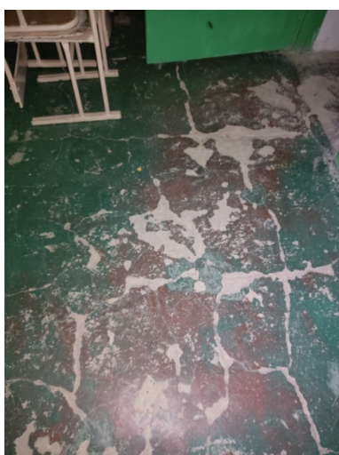
7.3.47 Растрескивание бетонного покрытия
