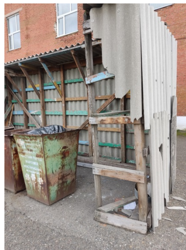
Фото 7.7.4 Износ элементов благоустройства
