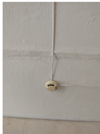
Фото 7.9.6.4 Открытая прокладка/провисание линий сетей связи/износ датчиков сигнализации
