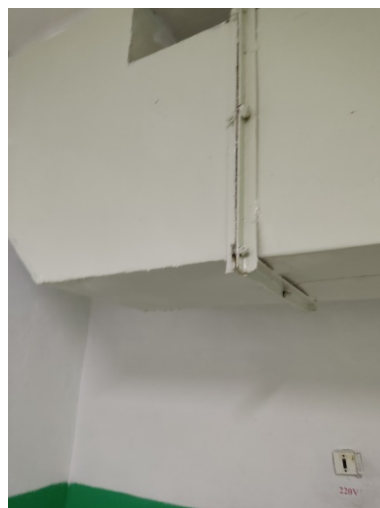
Фото 7.9.5.16 Деформация/загрязнение вент каналов
