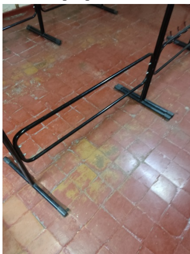
7.3.41 Истирание/износ напольной плитки
