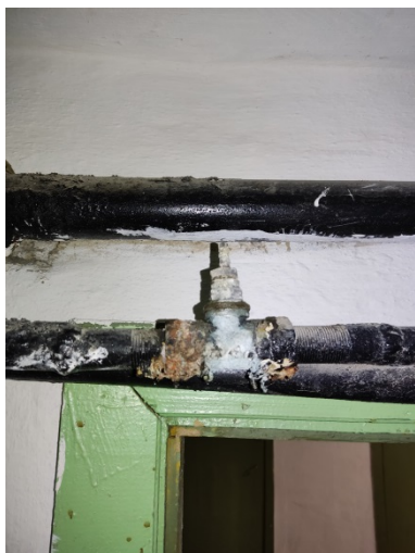
7.9.2.15 Коррозия запорной арматуры
