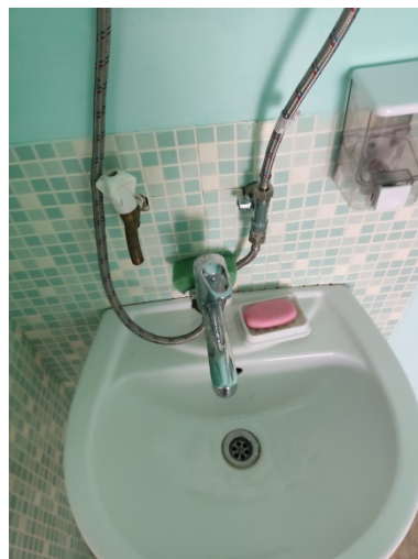
7.9.2.8 Износ санитарно-технических приборов
