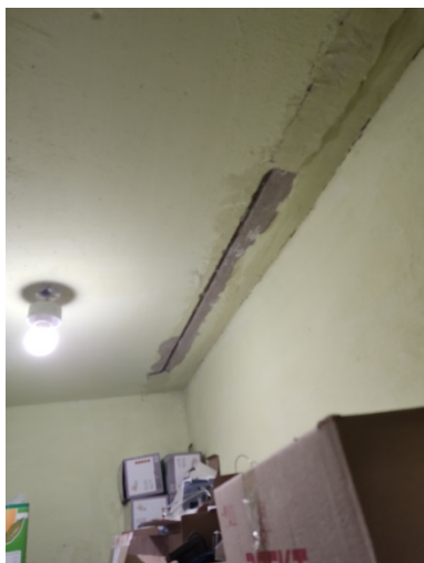
7.3.39 Деформация/выкрашивание монтажного шва между плитами перекрытиями
