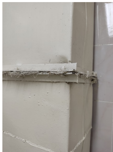
Фото 7.9.5.6 Деформация/загрязнение вент каналов
