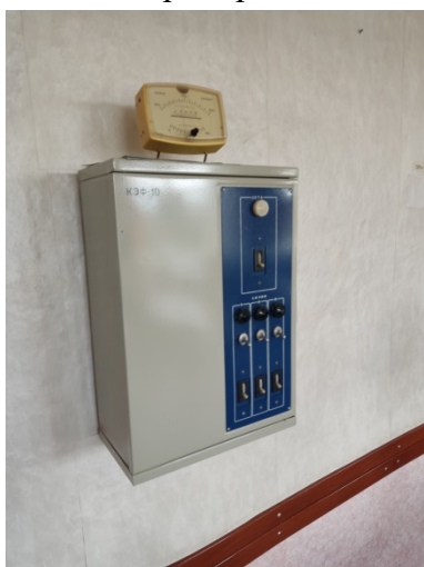
Фото 7.9.4.5 Износ электротехнических приборов
