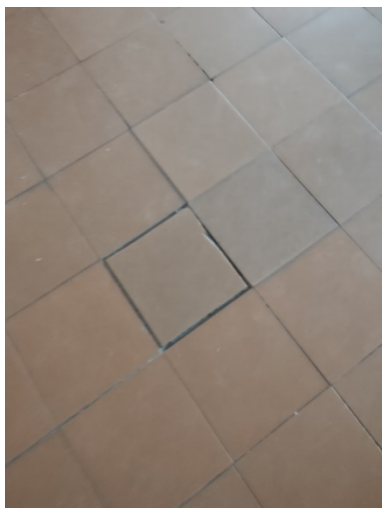
7.3.43 Истирание/износ напольной плитки
