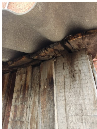
Фото 7.6.8 Гниение/рассыхание деревянных элементов
