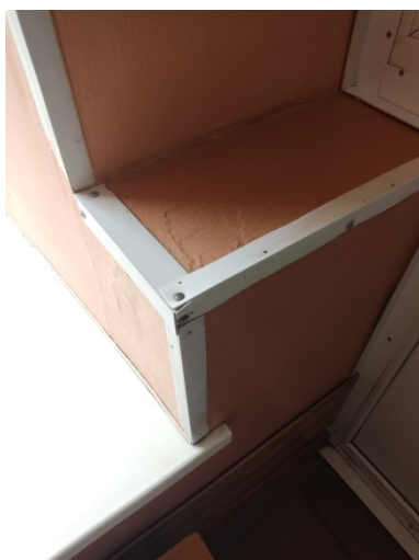
Фото 7.2.35 Разрушение элементов отделки
