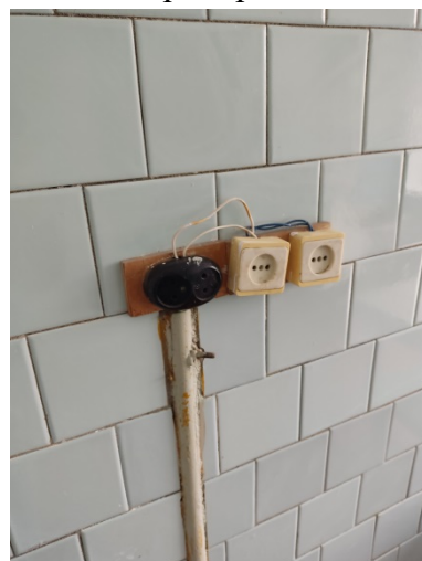
Фото 7.9.4.24 Износ электротехнических приборов
