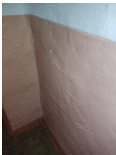
Фото 7.2.24 Нарушение геометрии штукатурного слоя (волны, наплывы)
