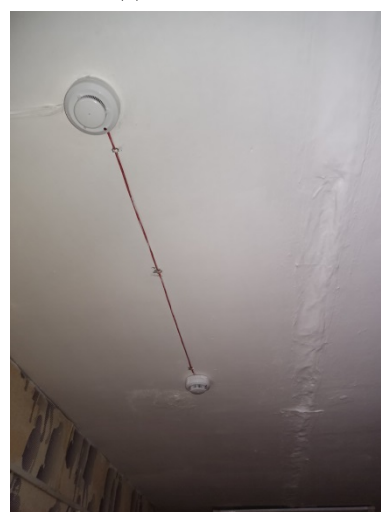
Фото 7.9.6.14 Открытая прокладка/провисание линий сетей связи/износ датчиков сигнализации
