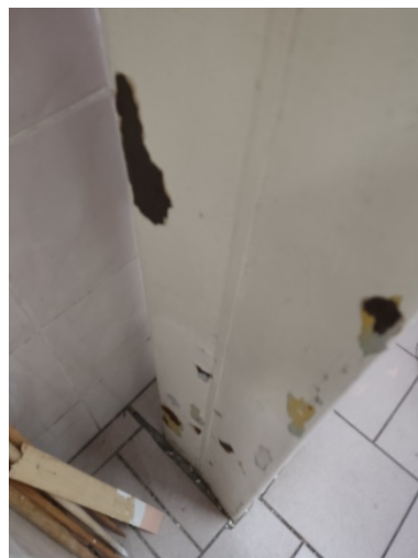
Фото 7.9.5.12 Коррозия /загрязнение вент каналов
