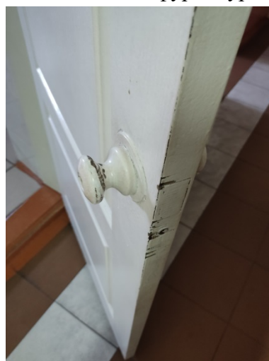
Фото 7.8.16 Рассыхание дверного полотна/износ фурнитуры
