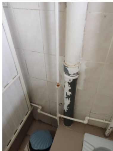
7.9.2.6 Следы протечек/износ трубопроводов
