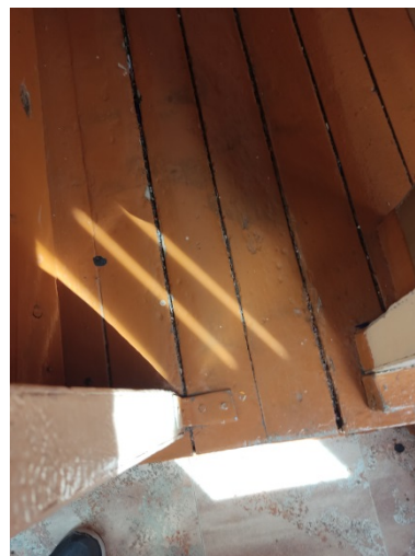
7.3.20 Рассыхание деревянных элементов пола
