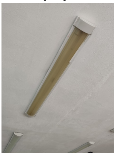
Фото 7.9.4.15 Износ электротехнических приборов
