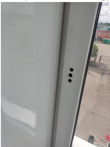
Фото 7.8.5 Отсутствие элементов фурнитуры
