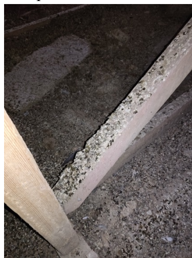
Фото 7.5.6 Следы загрязнения чердачного помещения
