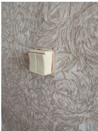
Фото 7.9.4.7 Износ электротехнических приборов
