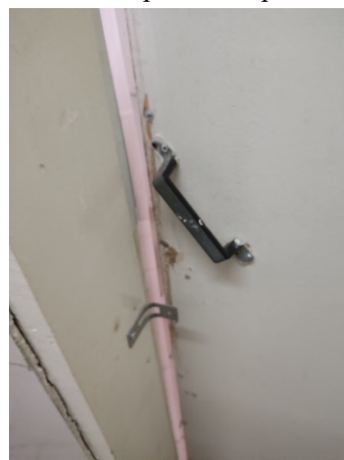
Фото 7.8.10 Рассыхание дверного полотна/износ фурнитуры
