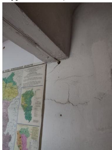
Фото 7.2.26 Растрескивание штукатурного слоя
