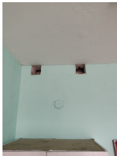
Фото 7.9.5.18 Отсутствие вентиляционных решеток
