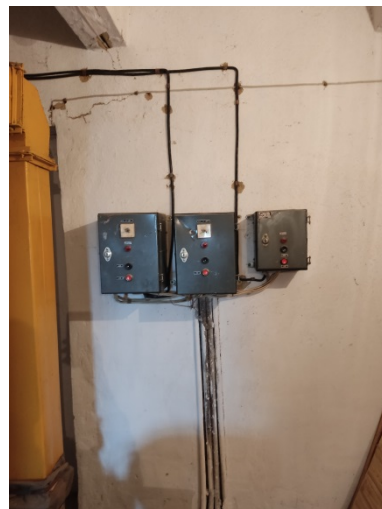
Фото 7.9.4.12 Износ электротехнических приборов
