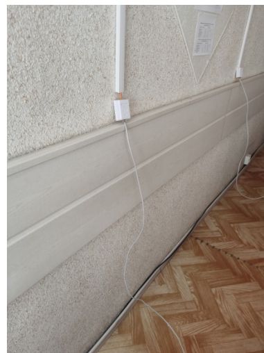
Фото 7.9.6.10 Открытая прокладка/провисание линий сетей связи
