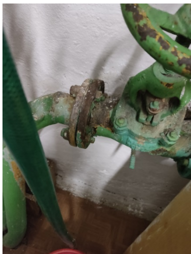
7.9.2.13 Коррозия запорной арматуры
