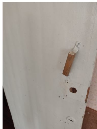
Фото 7.8.6 Рассыхание дверного проема/многократное окрашивание
