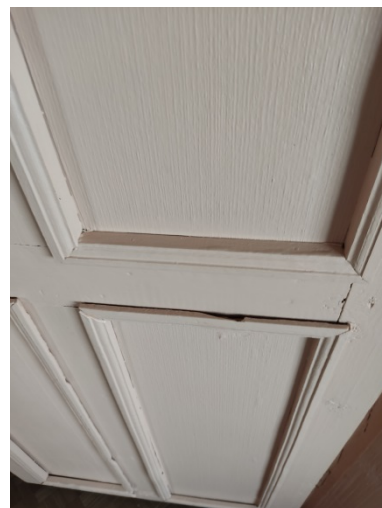
Фото 7.8.8 Рассыхание дверного проема/многократное окрашивание
