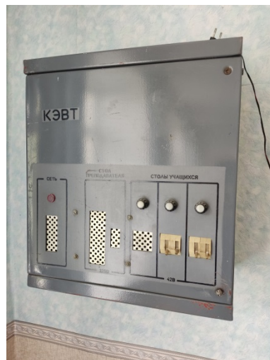
Фото 7.9.4.2 Износ электротехнических приборов
