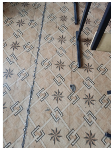
Фото 7.3.2 Повреждение линолеума, следы многократного ремонта
