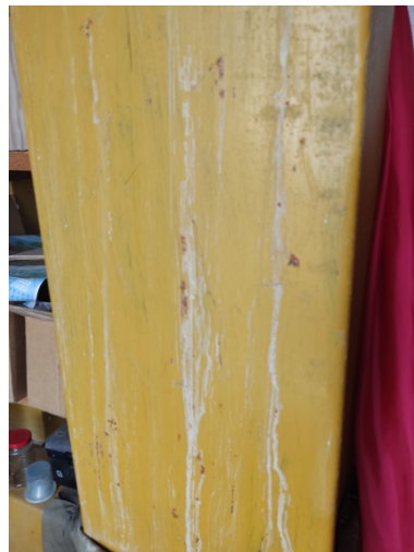
Фото 7.9.5.2 Деформация/загрязнение вент каналов
