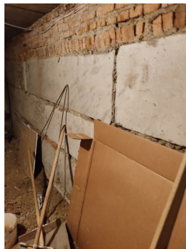
Фото 7.2.40 Отсутствие финишной отделки стен
