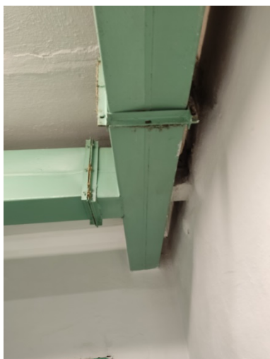
Фото 7.9.5.21 Деформация/загрязнение вент каналов
