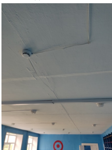
Фото 7.9.6.13 Открытая прокладка/провисание линий сетей связи/износ датчиков сигнализации
