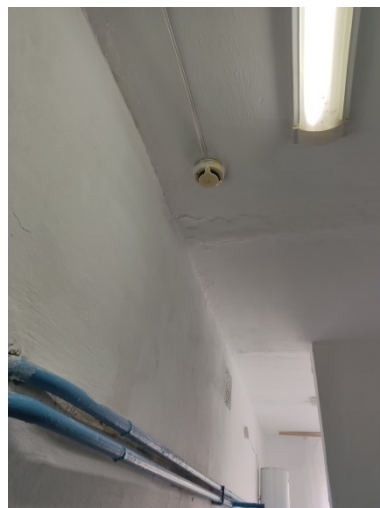
Фото 7.9.6.16 Открытая прокладка/провисание линий сетей связи/износ датчиков сигнализации
