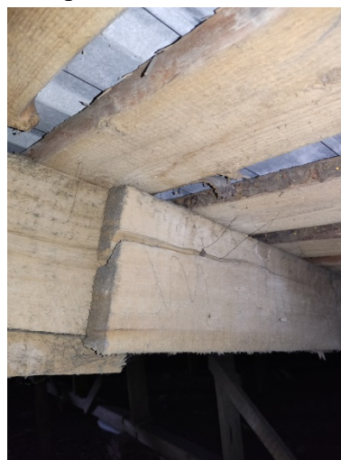
Фото 7.5.4 Рассыхание/деформация деревянных элементов
