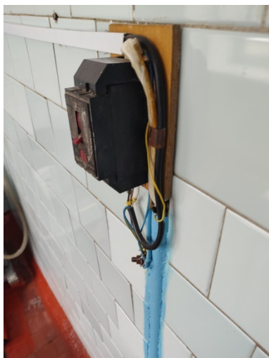
Фото 7.9.4.25 Открытая прокладка/провисание кабельных линий
