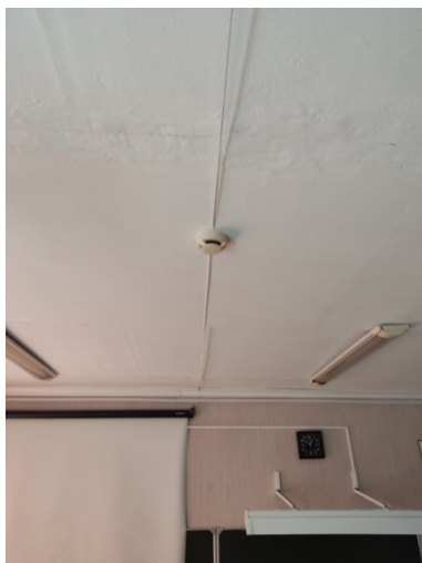
Фото 7.9.6.15 Открытая прокладка/провисание линий сетей связи/износ датчиков сигнализации
