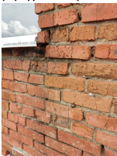
Фото 7.2.3 Выветривание раствора/разрушение кирпичной кладки
