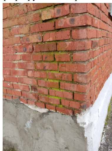
Фото 7.2.4 Следы влаги/плесени кирпичной кладки
