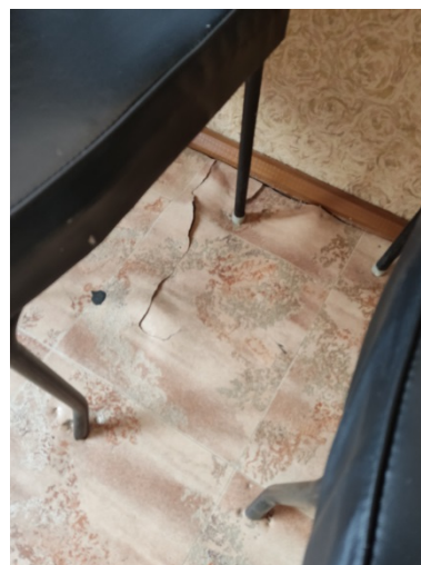
7.3.18 Повреждение линолеума, следы многократного ремонта
