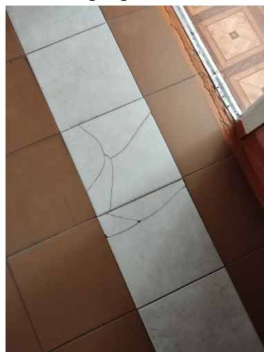
7.3.42 Растрескивание напольной плитки
