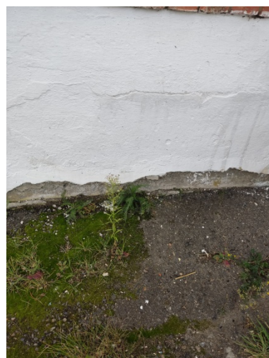
Фото 7.2.6 Отслаивание штукатурного слоя
