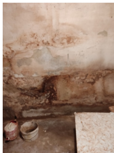
Фото 7.2.16 Следы увлажнения стен
