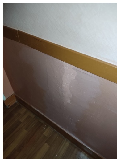
Фото 7.2.30 Нарушение геометрии штукатурного слоя (волны, наплывы)
