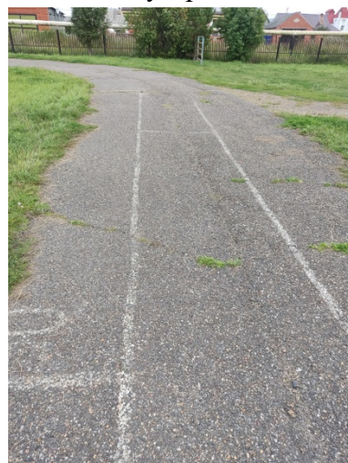
Фото 7.7.10 Разрушение асфальтового покрытия
