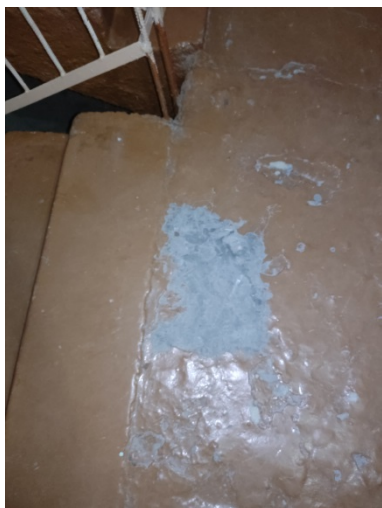
Фото 7.4.9 Истирание лакокрасочного покрытия
