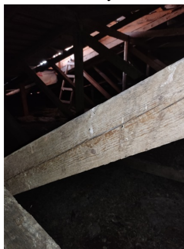
Фото 7.5.2 Рассыхание/деформация деревянных элементов
