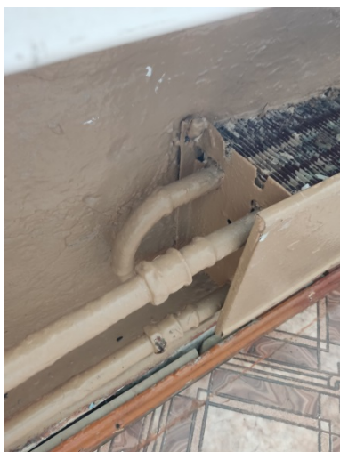
Фото 7.9.1.5 Коррозия/износ приборов отопления
