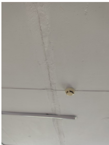
Фото 7.3.1 Деформация монтажного шва между плитами перекрытиями
