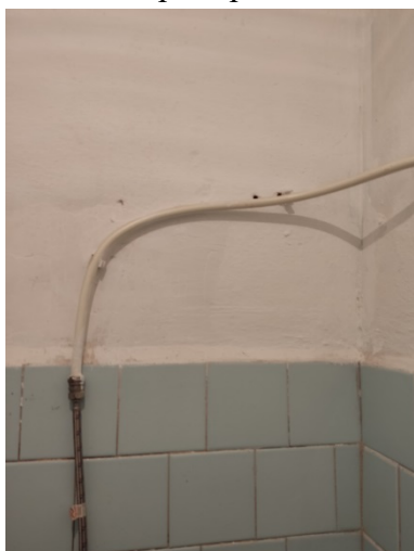
7.9.2.11 Деформация/провисание трубопроводов водоснабжения
