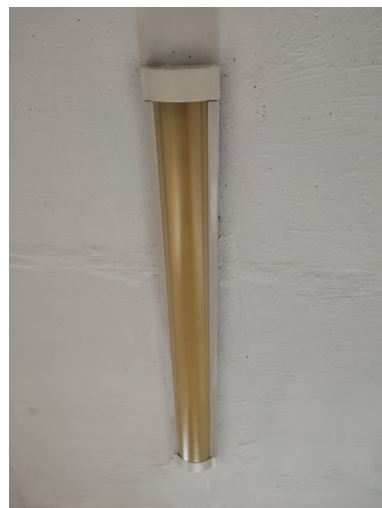
Фото 7.9.4.8 Износ электротехнических приборов
