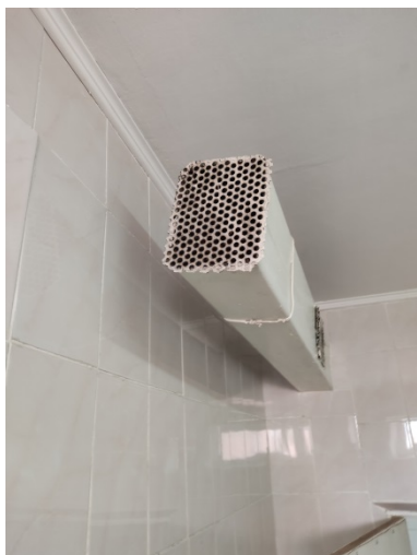
Фото 7.9.5.11 Деформация/загрязнение вент каналов
