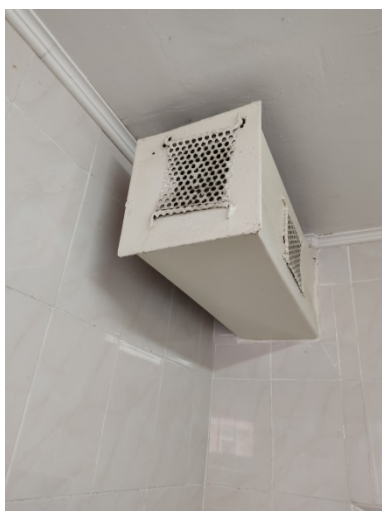
Фото 7.9.5.19 Деформация/загрязнение вент каналов
