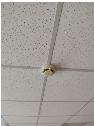
Фото 7.9.6.3 Износ датчиков сигнализации
