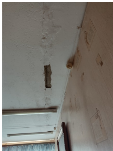
7.3.40 Деформация/выкрашивание монтажного шва между плитами перекрытиями
