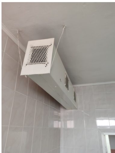
Фото 7.9.5.5 Деформация/загрязнение вент каналов
