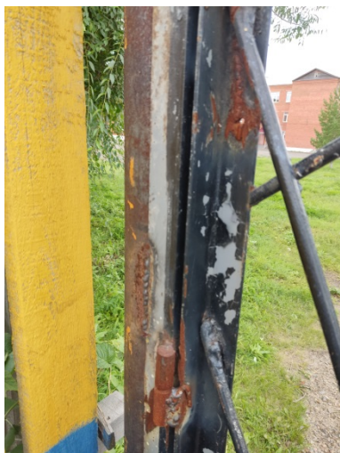
Фото 7.7.3 Коррозия основных элементов
