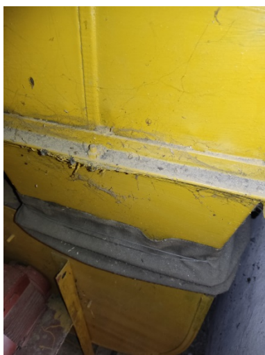
Фото 7.9.5.7 Деформация/загрязнение вент каналов
