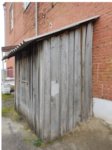
Фото 7.6.7 Гниение/рассыхание деревянных элементов
