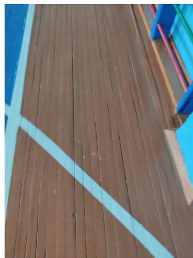
7.3.24 Рассыхание деревянных элементов пола
