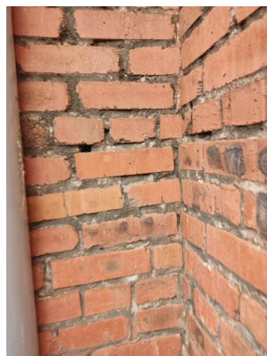
Фото 7.2.12 Следы размораживания кирпичной кладки
