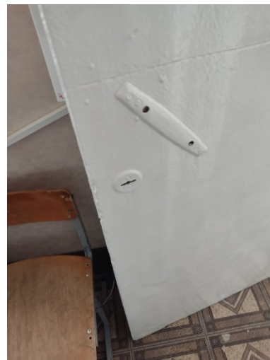
Фото 7.8.12 Рассыхание дверного полотна/износ фурнитуры
