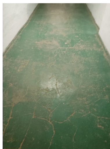
7.3.48 Растрескивание бетонного покрытия
