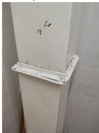
Фото 7.9.5.10 Деформация/загрязнение вент каналов
