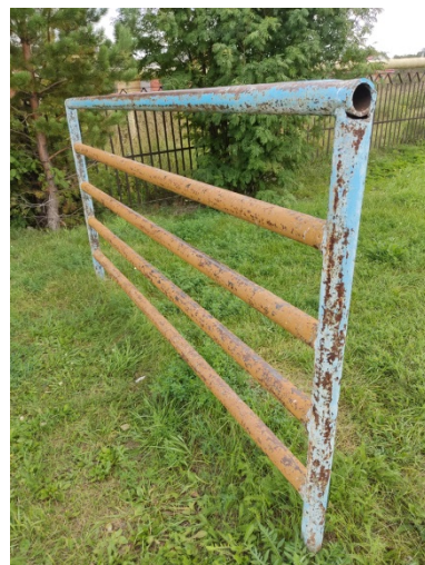
Фото 7.7.6 Износ элементов благоустройства
