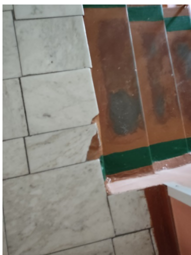
Фото 7.4.1 Разрушение напольной плитки площадок
