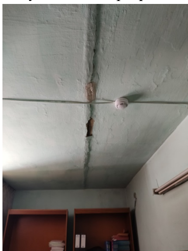
7.3.17 Деформация/выкрашивание монтажного шва между плитами перекрытиями
