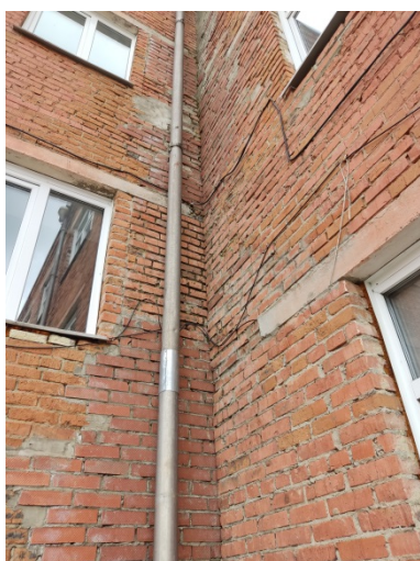
Фото 7.2.9 Следы размораживания кирпичной кладки
