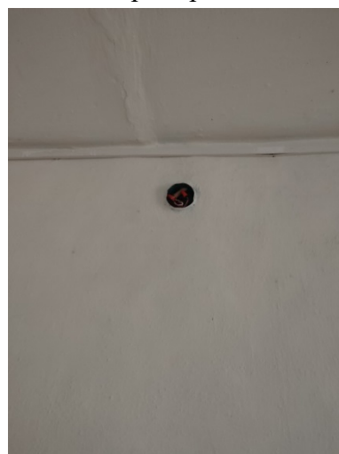
Фото 7.9.4.10 Отсутствие элементов системы электроснабжения
