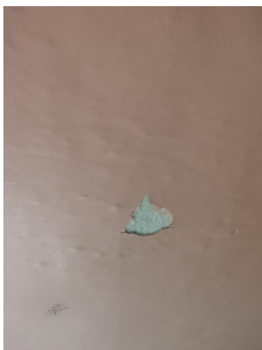
Фото 7.2.23 Отслаивание штукатурного слоя
