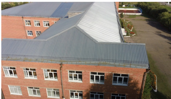
Фото 7.5.1 Рассыхание/деформация деревянных элементов
