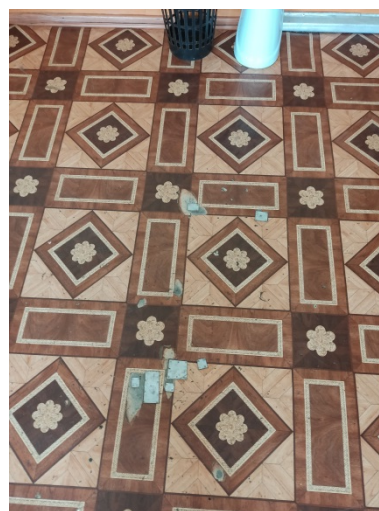
7.3.34 Повреждение линолеума, следы многократного ремонта
