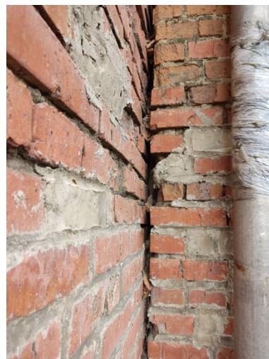
Фото 7.2.2 Выветривание раствора/разрушение кирпичной кладки
