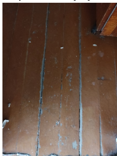
Фото 7.3.10 Рассыхание деревянных элементов пола
