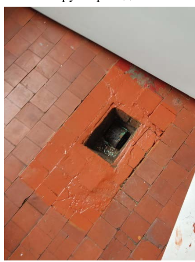
Фото 7.9.3.6 Загрязнение канализационных трапов
