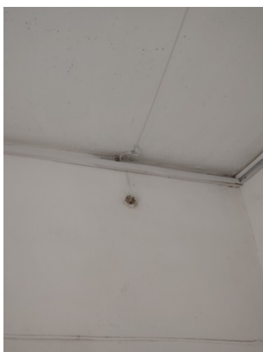
Фото 7.9.6.7 Открытая прокладка/провисание линий сетей связи/износ датчиков сигнализации
