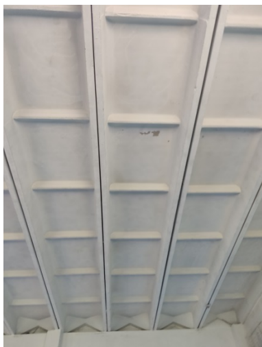
7.3.25 Отслаивание штукатурного слоя
