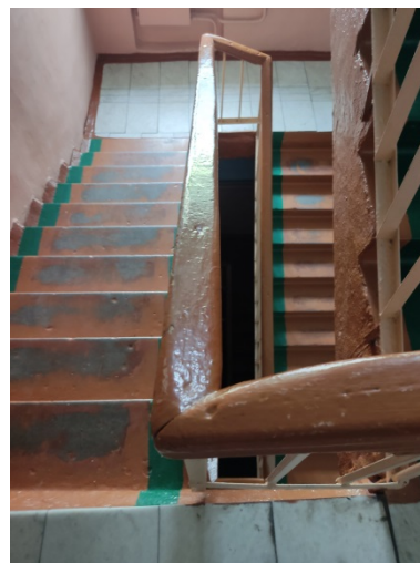
Фото 7.4.4 Истирание лакокрасочного покрытия
