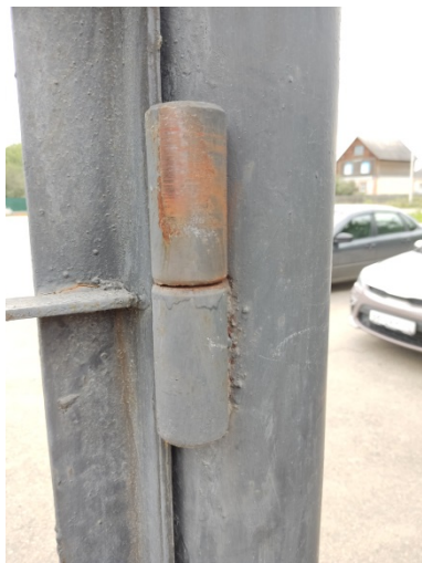
Фото 7.7.1 Коррозия основных элементов
