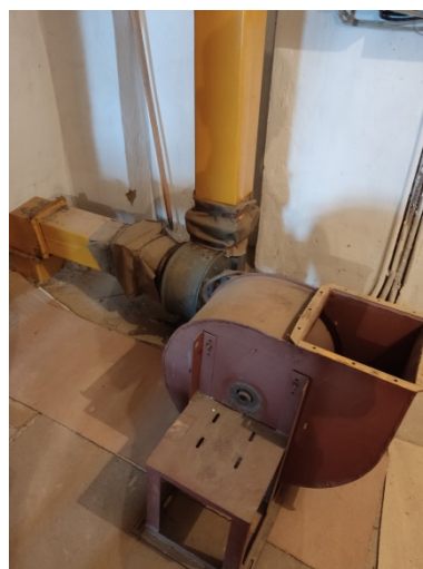
Фото 7.9.5.8 Износ вентиляционных установок
