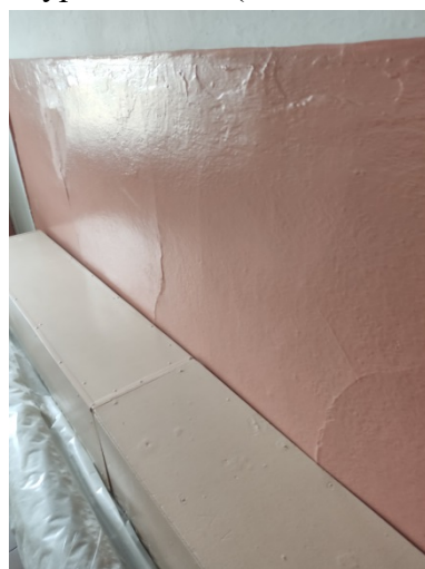
Фото 7.2.36 Растрескивание штукатурного слоя
