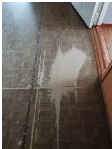
Фото 7.3.12 Повреждение линолеума, следы многократного ремонта
