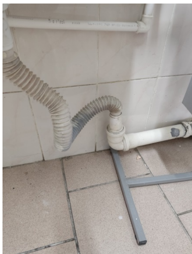
Фото 7.9.3.1 Износ элементов канализации
