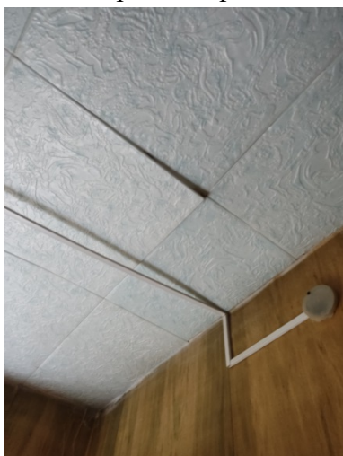
7.3.23 Отслаивание потолочных панелей
