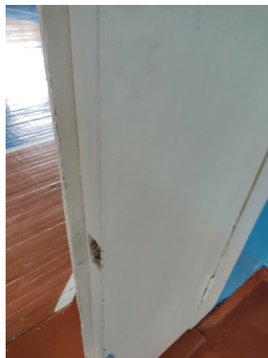
Фото 7.8.14 Рассыхание дверного полотна/износ фурнитуры
