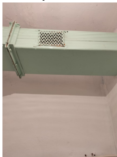
Фото 7.9.5.22 Деформация/загрязнение вент каналов
