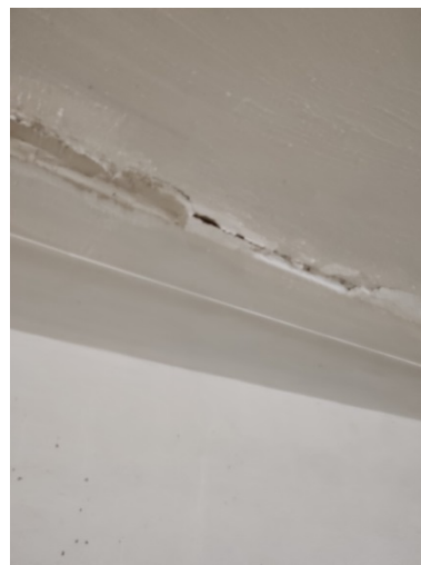
7.3.44 Деформация/выкрашивание монтажного шва между плитами перекрытиями
