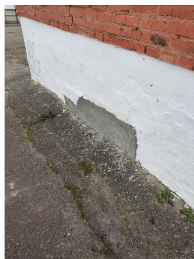
Фото 7.2.10 Отслаивание штукатурного слоя
