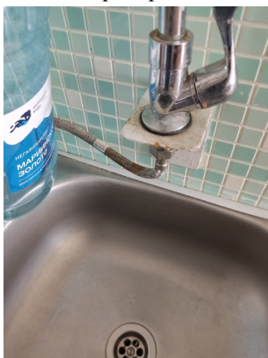
7.9.2.9 Износ санитарно-технических приборов
