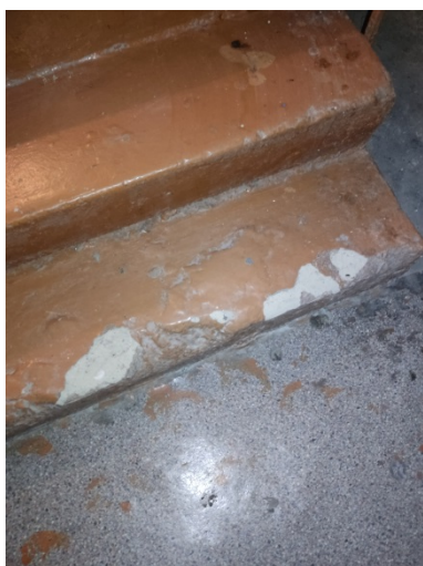
Фото 7.4.7 Сколы ступеней лестничного марша
