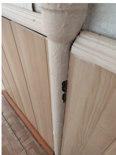
Фото 7.9.3.3 Разрушение лакокрасочного слоя
