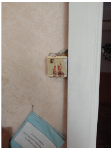
Фото 7.9.4.13 Износ электротехнических приборов
