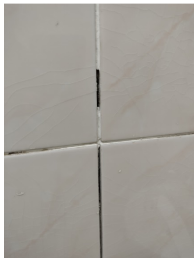
Фото 7.2.22 Выкрашивание межплиточного шва
