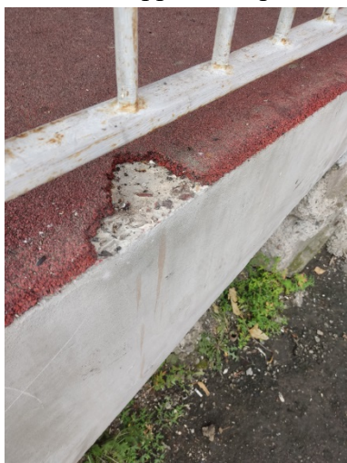
Фото 7.6.11 Разрушение покрытия крылец
