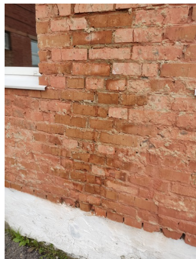
Фото 7.2.8 Следы увлажнения кирпичной кладки
