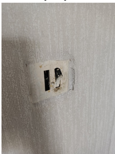
Фото 7.9.4.21 Износ электротехнических приборов
