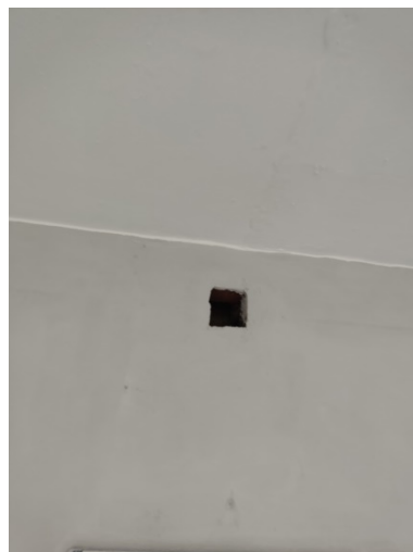
Фото 7.9.5.4 Отсутствие вентиляционных решеток
