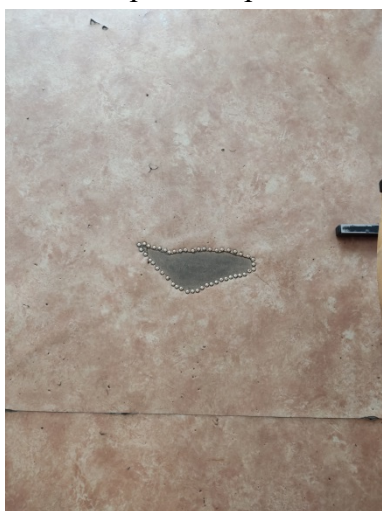
7.3.21 Повреждение линолеума, следы многократного ремонта
