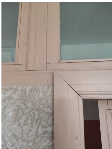
Фото 7.8.7 Рассыхание деревянных элементов
