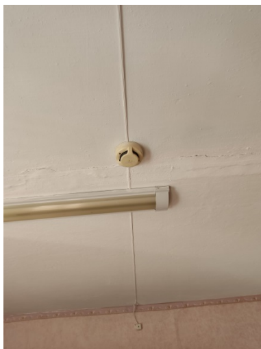
Фото 7.9.6.9 Износ датчиков сигнализации
