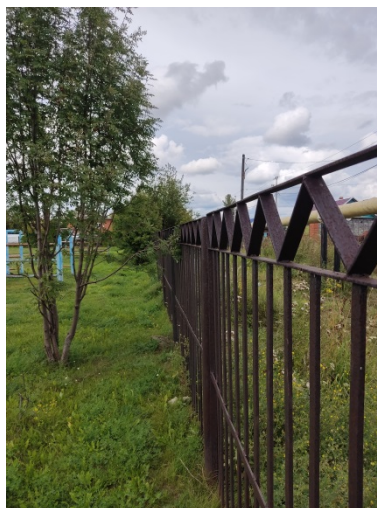
Фото 7.7.11 Смещение/деформация элементов системы ограждения
