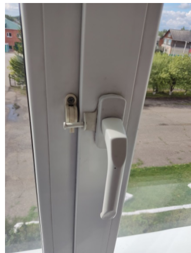
Фото 7.8.4 Износ элементов окна
