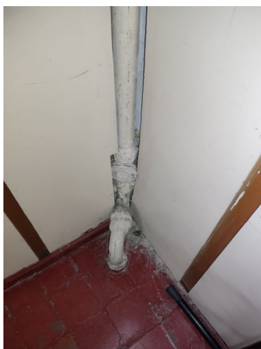
Фото 7.9.3.11 Износ трубопровода системы канализации
