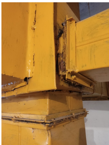
Фото 7.9.5.9 Коррозия /загрязнение вент каналов
