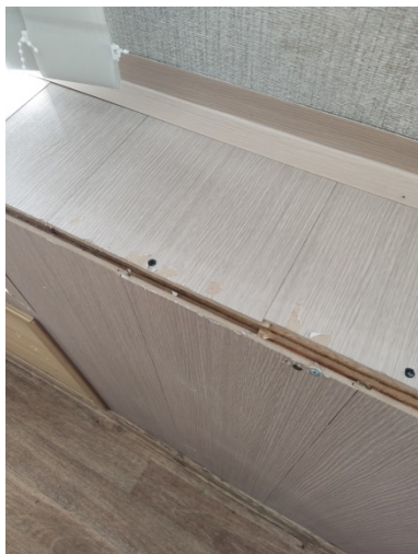
Фото 7.2.19 Разрушение элементов отделки
