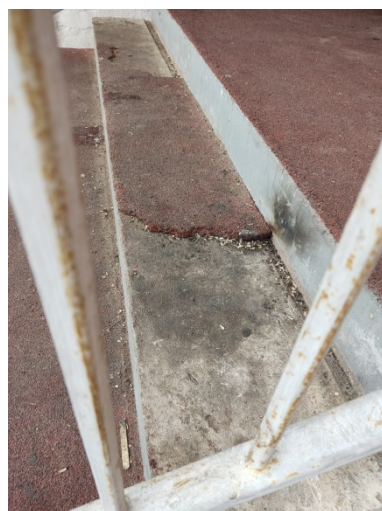
Фото 7.6.10 Разрушение покрытия крылец
