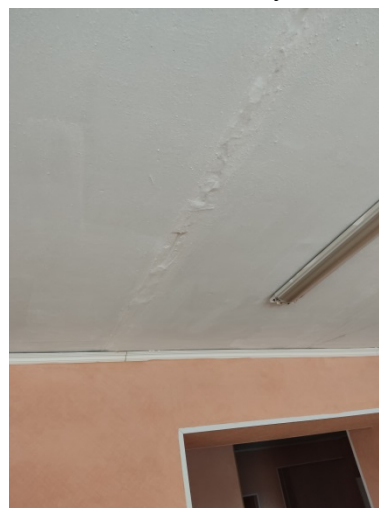
7.3.30 Деформация/выкрашивание монтажного шва между плитами перекрытиями
