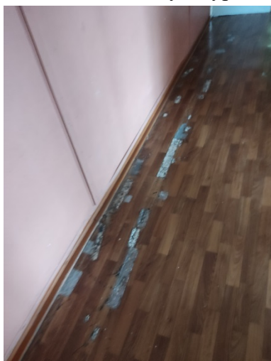
7.3.29 Повреждение линолеума, следы многократного ремонта
