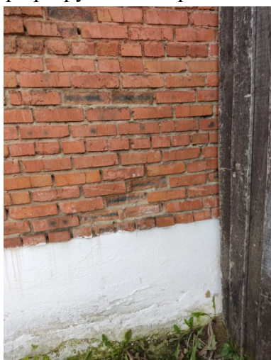
Фото 7.2.5 Выветривание раствора/разрушение кирпичной кладки
