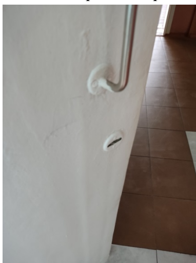
Фото 7.8.15 Рассыхание дверного полотна/износ фурнитуры
