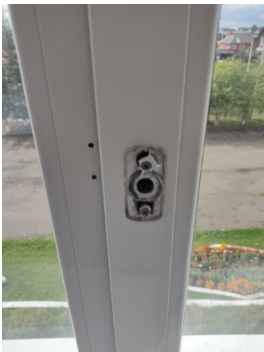
Фото 7.8.3 Отсутствие элементов фурнитуры
