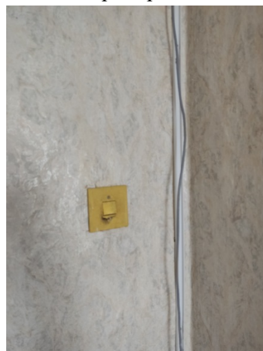
Фото 7.9.4.4 Износ электротехнических приборов
