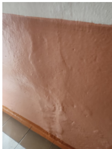
Фото 7.2.34 Нарушение геометрии штукатурного слоя (волны, наплывы)
