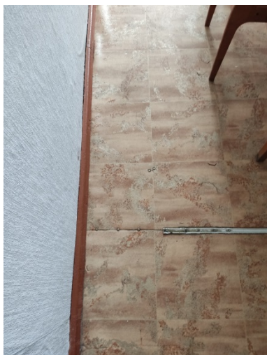
7.3.31 Повреждение линолеума, следы многократного ремонта
