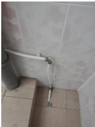
Фото 7.9.2.1 Деформация/провисание трубопроводов водоснабжения
