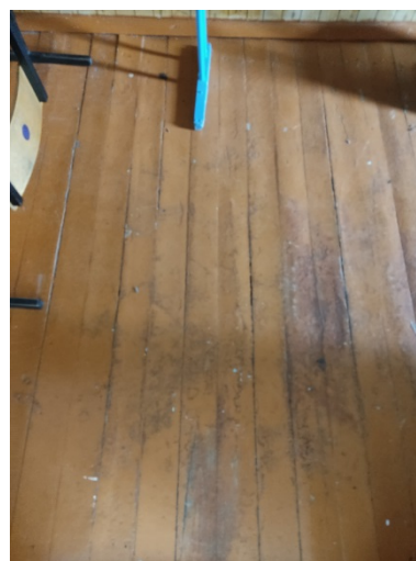
7.3.22 Рассыхание деревянных элементов пола
