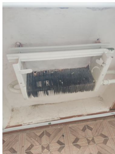
Фото 7.9.1.8 Коррозия/износ приборов отопления
