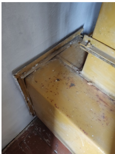
Фото 7.9.5.3 Коррозия/загрязнение вент каналов
