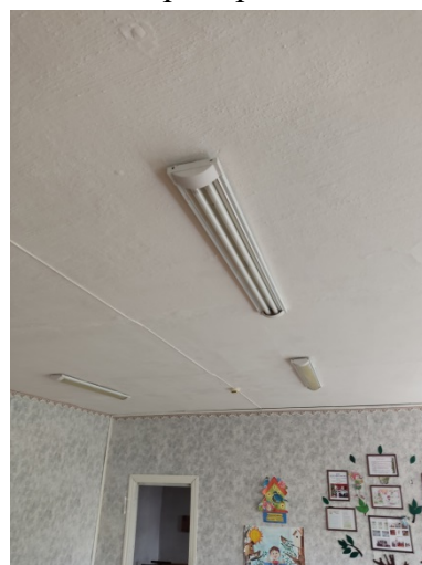
Фото 7.9.4.16 Отсутствие защитных плафонов
