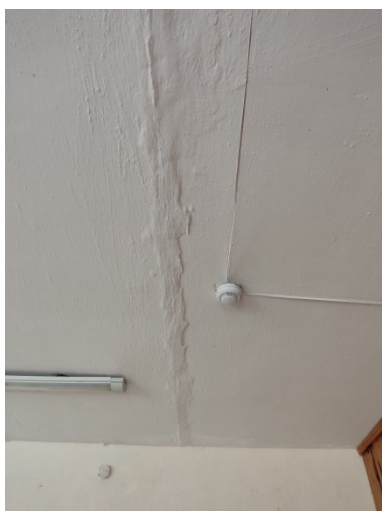
Фото 7.3.15 Деформация монтажного шва между плитами перекрытиями
