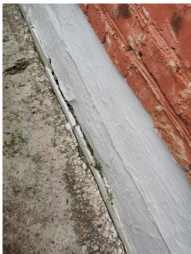
Фото 7.2.13 Отслаивание штукатурного слоя
