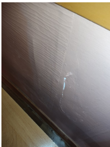
Фото 7.2.31 Отслаивание штукатурного слоя
