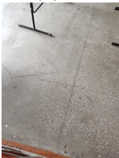
7.3.35 Растрескивание покрытия из мозаичного бетона
