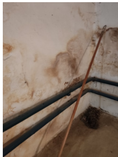
Фото 7.2.14 Следы увлажнения стен
