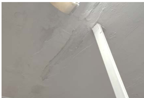
7.3.33 Деформация/выкрашивание монтажного шва между плитами перекрытиями
