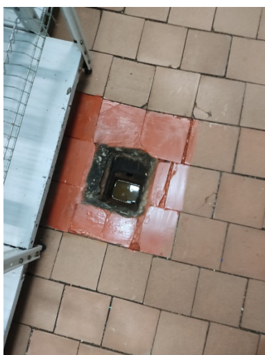
Фото 7.9.3.9 Загрязнение канализационных трапов
