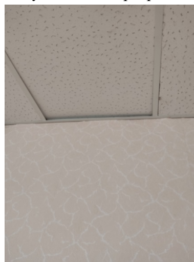
Фото 7.3.16 Деформация элементов подвесного потолка
