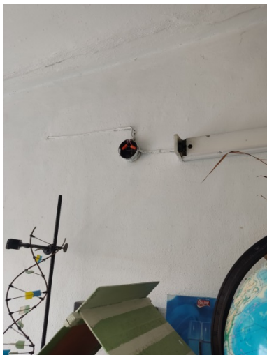
Фото 7.9.4.11 Отсутствие элементов системы электроснабжения
