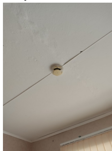
Фото 7.9.6.12 Открытая прокладка/провисание линий сетей связи/износ датчиков сигнализации
