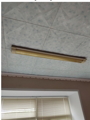
Фото 7.9.4.17 Износ электротехнических приборов
