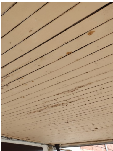
Фото 7.6.3 Рассыхание деревянных элементов
