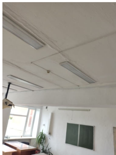
7.3.38 Деформация/выкрашивание монтажного шва между плитами перекрытиями
