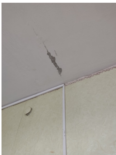
7.3.27 Отслаивание штукатурного слоя
