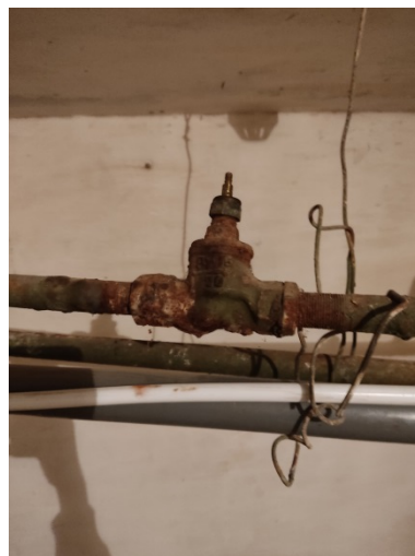
7.9.2.16 Коррозия запорной арматуры
