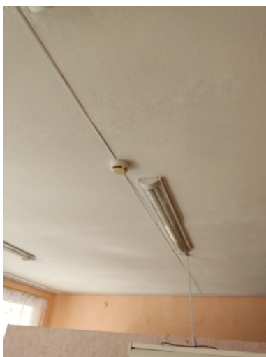
Фото 7.9.6.11 Открытая прокладка/провисание линий сетей связи/износ датчиков сигнализации
