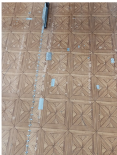
Фото 7.3.3 Повреждение линолеума, следы многократного ремонта
