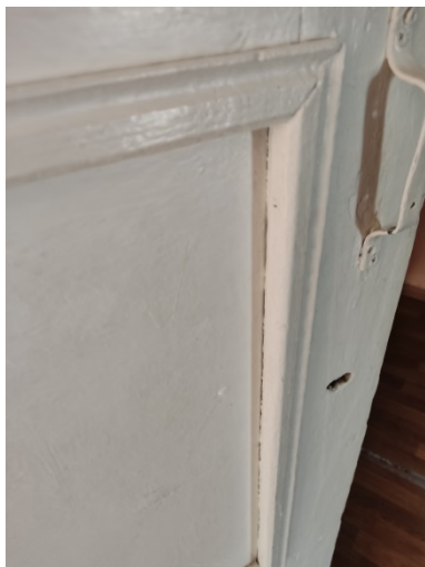
Фото 7.8.11 Рассыхание дверного полотна/износ фурнитуры
