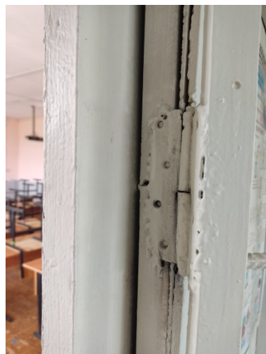
Фото 7.8.2 Рассыхание дверного полотна/износ фурнитуры
