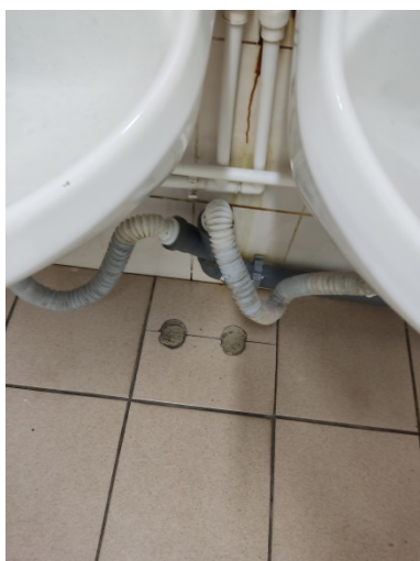
Фото 7.9.3.5 Износ элементов канализации
