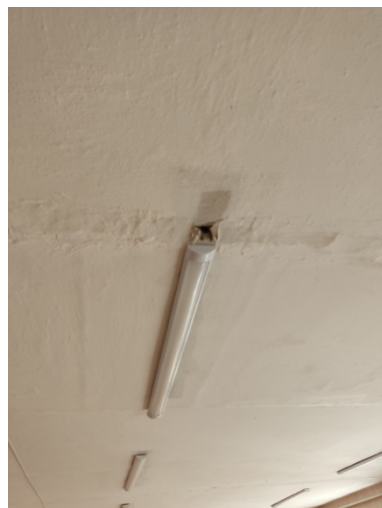
Фото 7.3.8 Деформация монтажного шва между плитами перекрытиями
