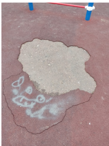
Фото 7.7.7 Износ элементов благоустройства
