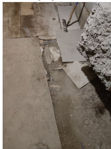
7.3.46 Отсутствие финишного покрытия пола
