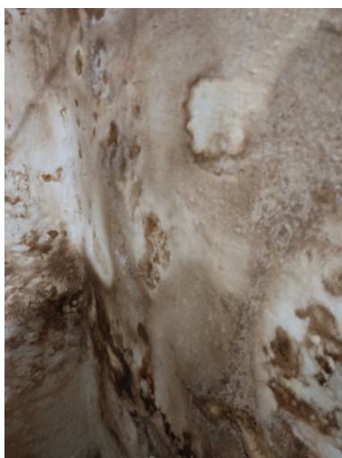
Фото 7.2.15 Следы увлажнения стен
