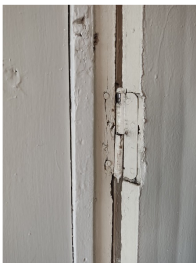
Фото 7.8.9 Рассыхание дверного полотна/износ фурнитуры
