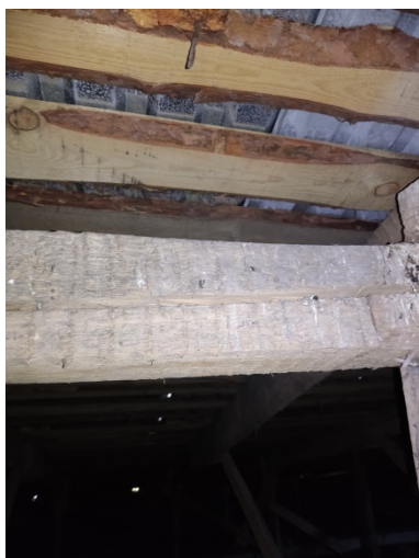
Фото 7.5.5 Рассыхание/деформация деревянных элементов
