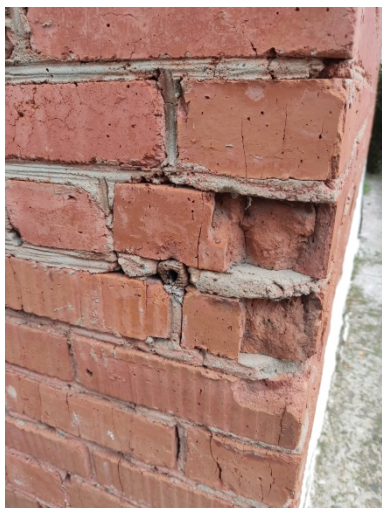
Фото 7.2.1 Выветривание раствора/разрушение кирпичной кладки
