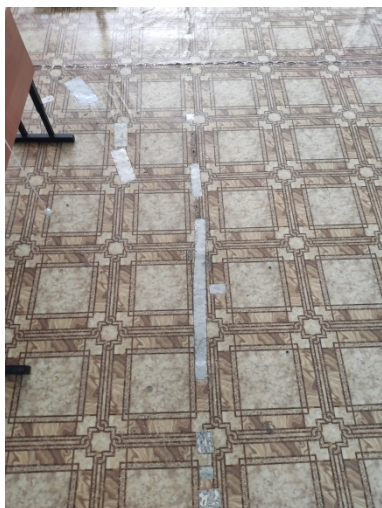
7.3.19 Повреждение линолеума, следы многократного ремонта
