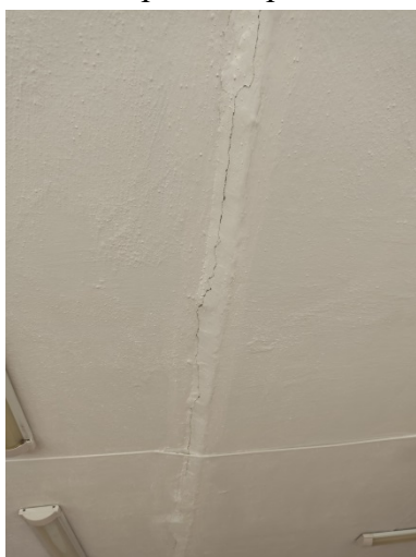
Фото 7.3.9 Деформация монтажного шва между плитами перекрытиями
