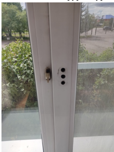
Фото 7.8.17 Отсутствие элементов фурнитуры
