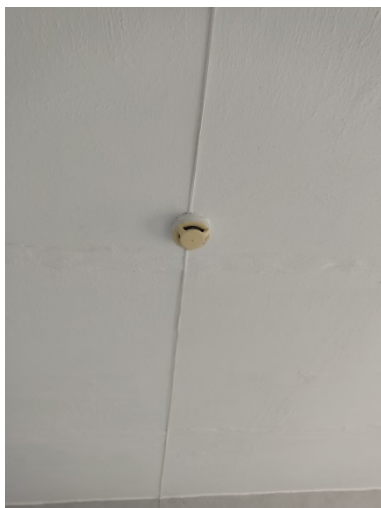
Фото 7.9.6.5 Открытая прокладка/провисание линий сетей связи/износ датчиков сигнализации
