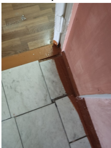
Фото 7.4.5 Разрушение напольной плитки площадок
