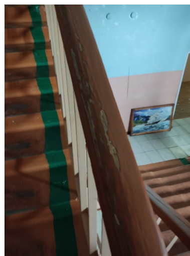
Фото 7.4.2 Рассыхание деревянных элементов
