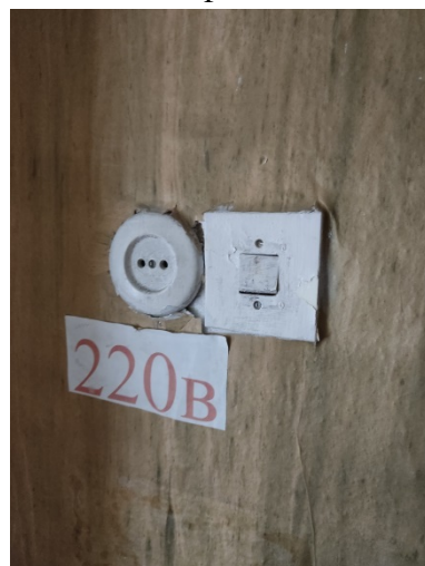
Фото 7.9.4.18 Износ электротехнических приборов
