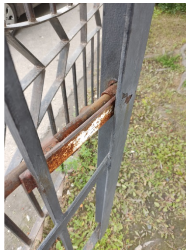
Фото 7.7.2 Коррозия основных элементов
