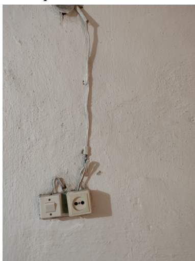
Фото 7.9.4.27 Открытая прокладка/провисание кабельных линий
