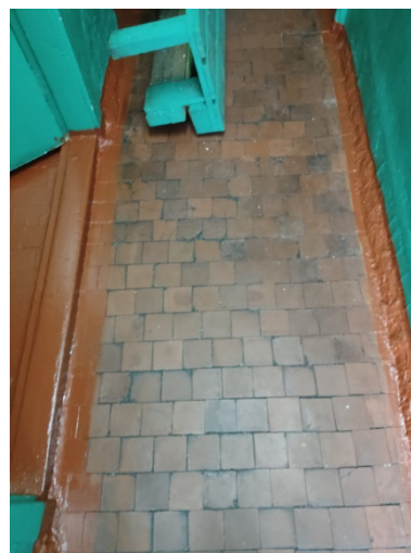
7.3.36 Истирание/износ напольной плитки
