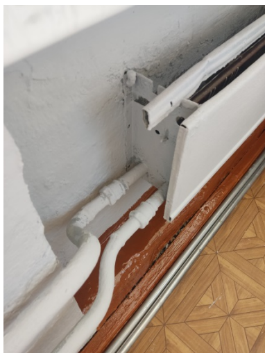
Фото 7.9.1.1 Многократное окрашивание/износ трубопровода
