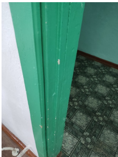
Фото 7.8.19 Рассыхание дверного полотна/износ фурнитуры
