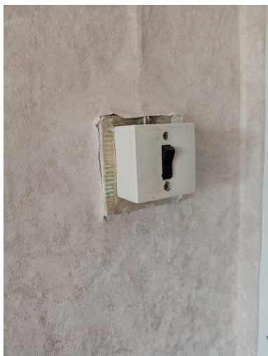
Фото 7.9.4.19 Износ электротехнических приборов
