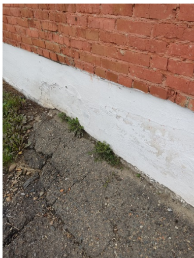
Фото 7.2.7 Отслаивание штукатурного слоя
