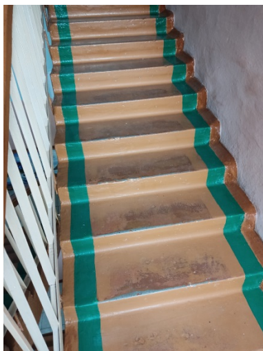
Фото 7.4.3 Истирание лакокрасочного покрытия
