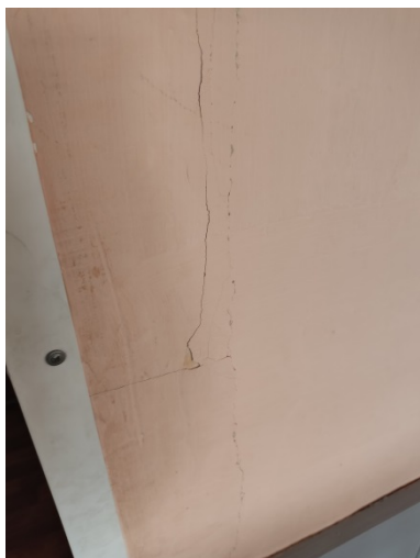
Фото 7.2.27 Растрескивание штукатурного слоя
