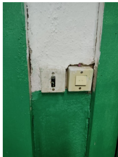
Фото 7.9.4.26 Износ электротехнических приборов
