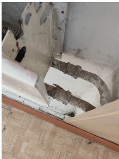
Фото 7.9.1.7 Коррозия/износ приборов отопления
